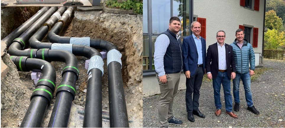
An der Wiesenstrasse wurde die erste städtische Liegenschaft an den Fernwärmeverbund der Regionalwerke AG Baden (RWB) angeschlossen. Seit Herbst 2023 werden dadurch jährlich 14 Tonnen CO 2 eingespart.
